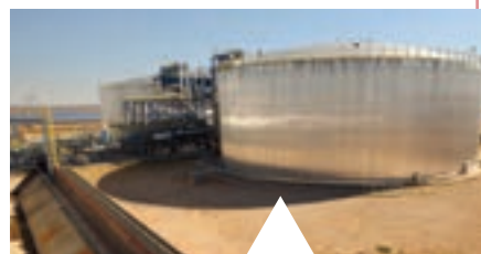
Detalle de los tanques de almacenamiento de la planta solar termoeléctrica Bokpoort (Sudáfrica) / Close-up of storage tanks at the Bokpoort solar thermal power plant (South Africa).
