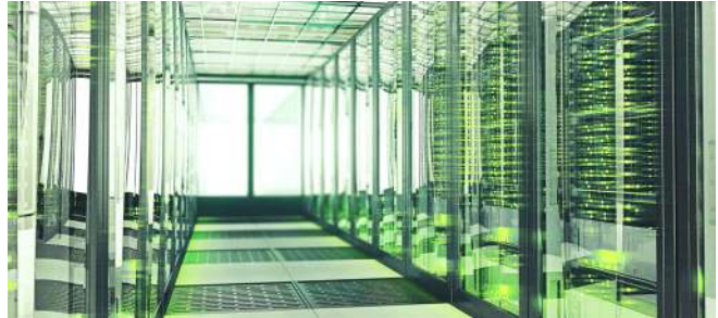
Energieeffizienteres heterogenes Hochleistungsrechnen
